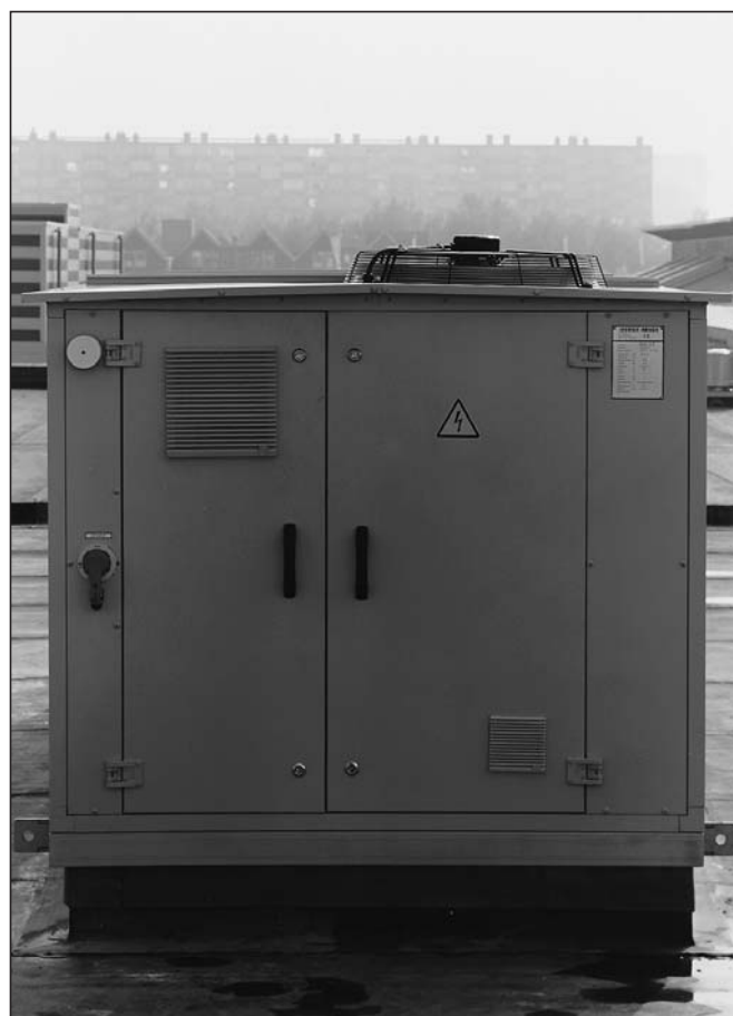
Schakelkast gesloten BDC 7
